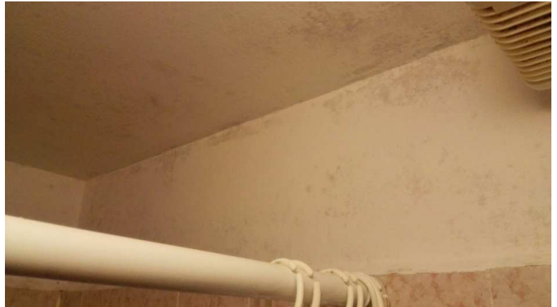
Douche met schimmel aan muren en plafond
