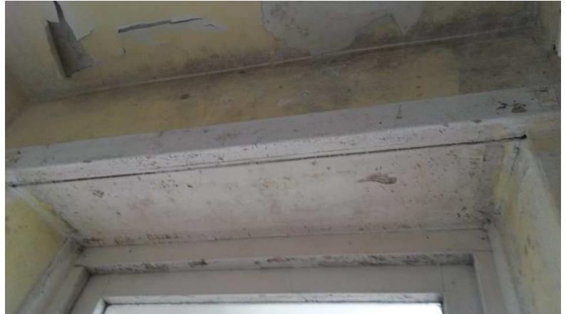
Beschimmeld kozijn en plafond
