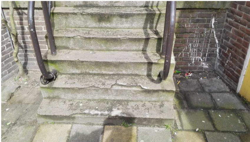
De trappen voor de ingang van de blokken in de Dobbestraat zijn in slechte staat
