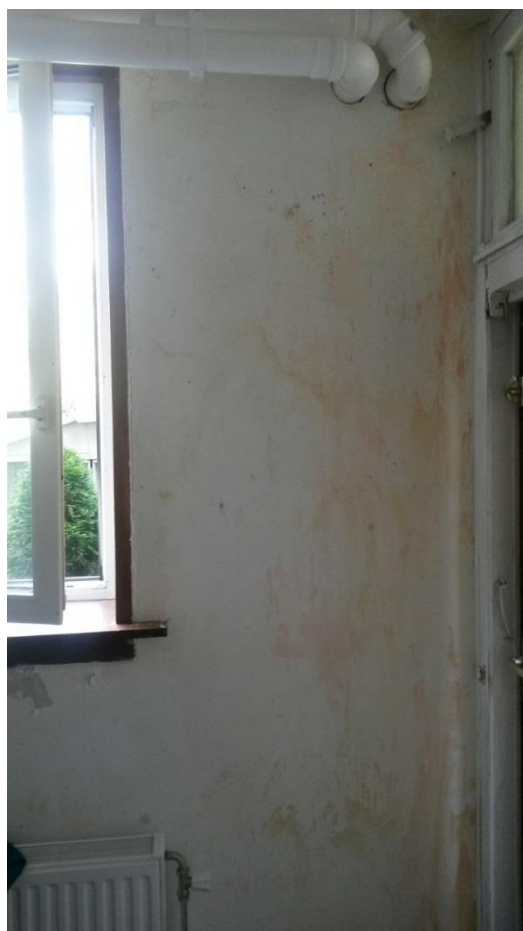
Een extreem vochtige muur in een woning aan het Columbusplein in Amsterdam West, eigendom van De Key
