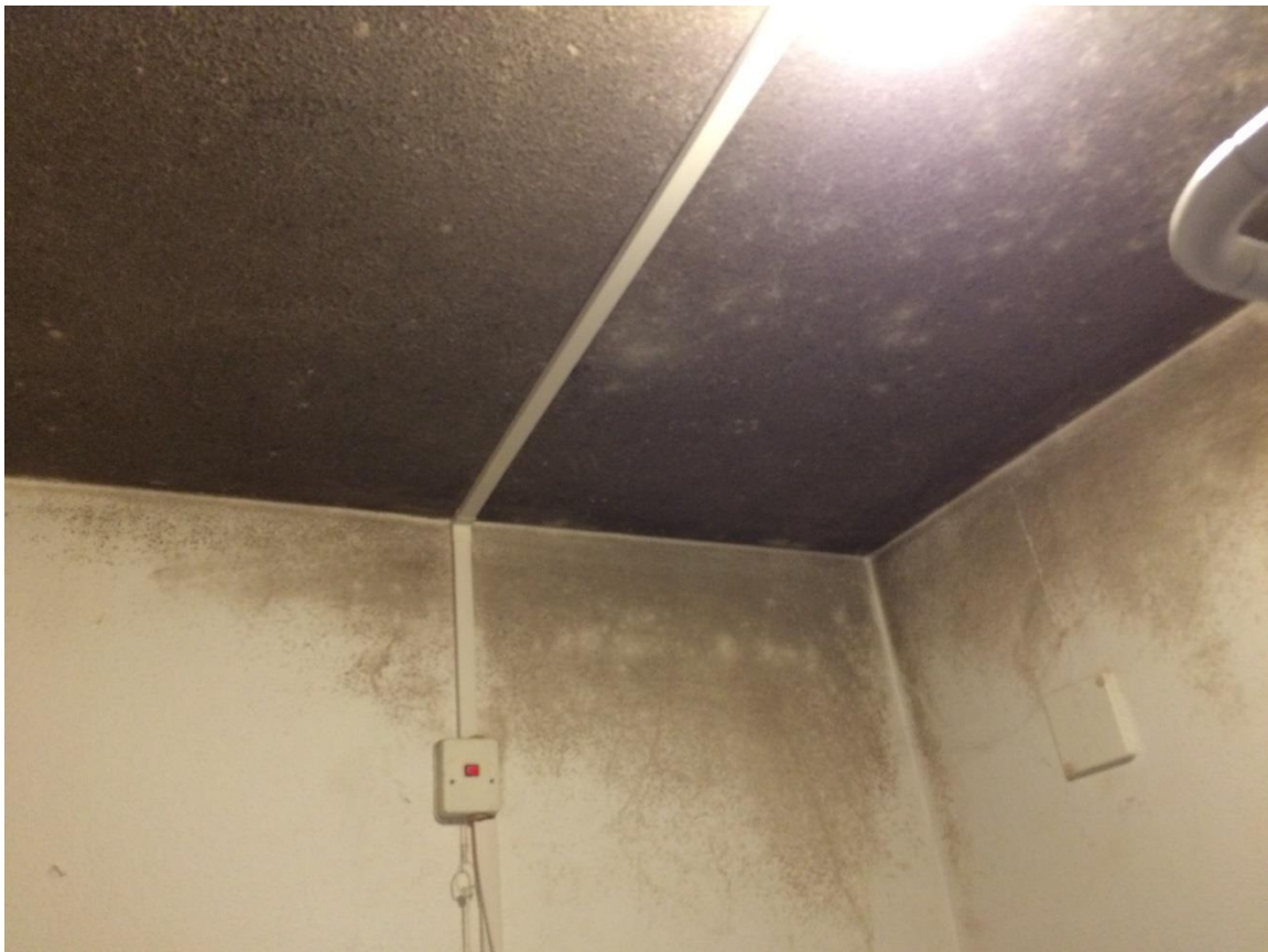
Een extreem beschimmelde badkamer in een woning van Stadgenoot aan de Mischeeps in Amsterdam Noord
