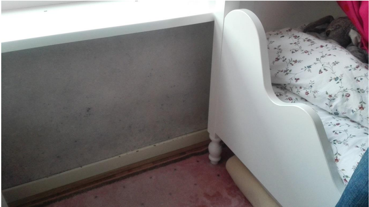
Schimmel op de buitenmuur in de slaapkamer van een kind in de Lucellestraat in Bos en Lommer. Ook de kozijnen waren erg beschimmeld. De woning is eigendom van particuliere verhuurder RVG.
