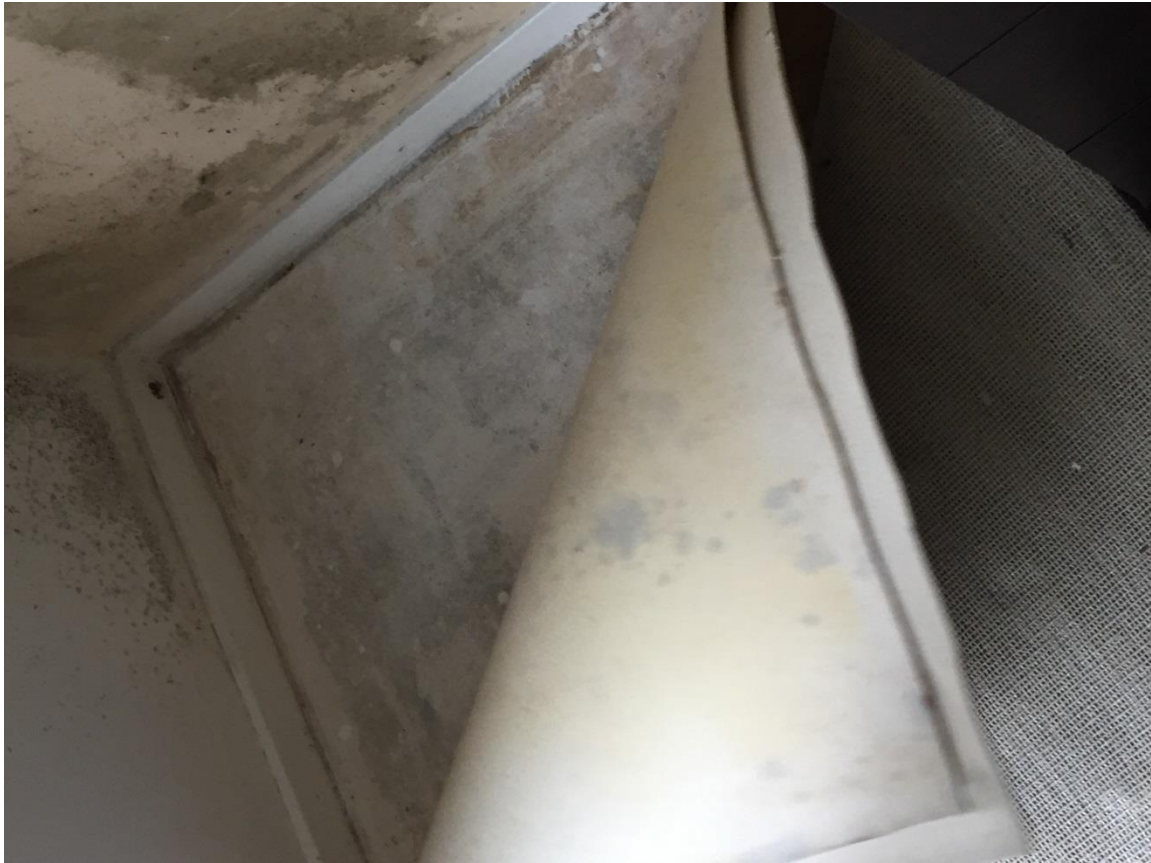
Schimmel onder de vloer en op de muur in een woning aan de Naardermeerstraat, eigendom van Eigen Haard
