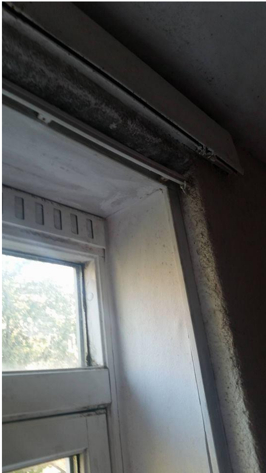
Een beschimmeld kozijn en muur/plafond in de Lodewijk van Deysselbuurt, eigendom van Rochdale
