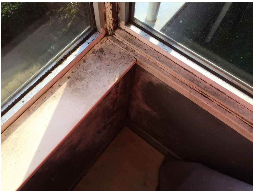
Schimmel in een woning in Holendrecht
