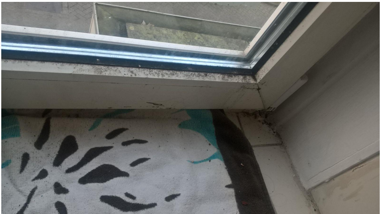
Het lijkt op stof, maar het is telkens terugkerende schimmel in een woning in de Dolfijnhof in Amsterdam Noord, eigendom van Ymere
